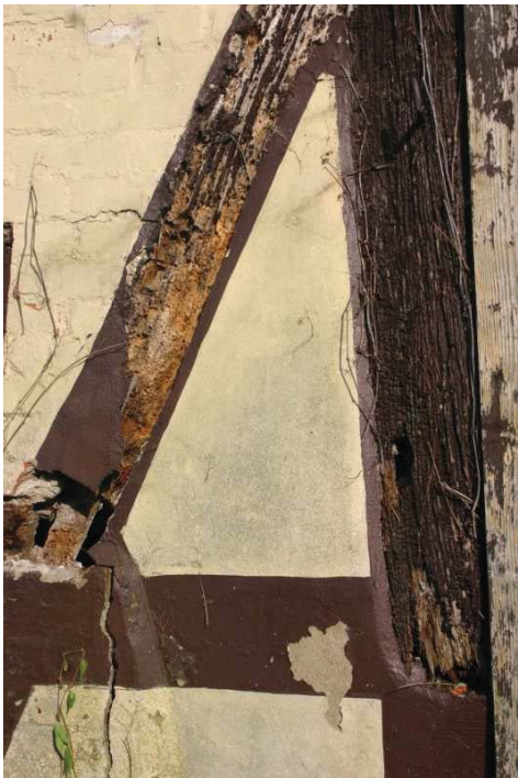
Abb. 7: Schaden durch Feuchte
