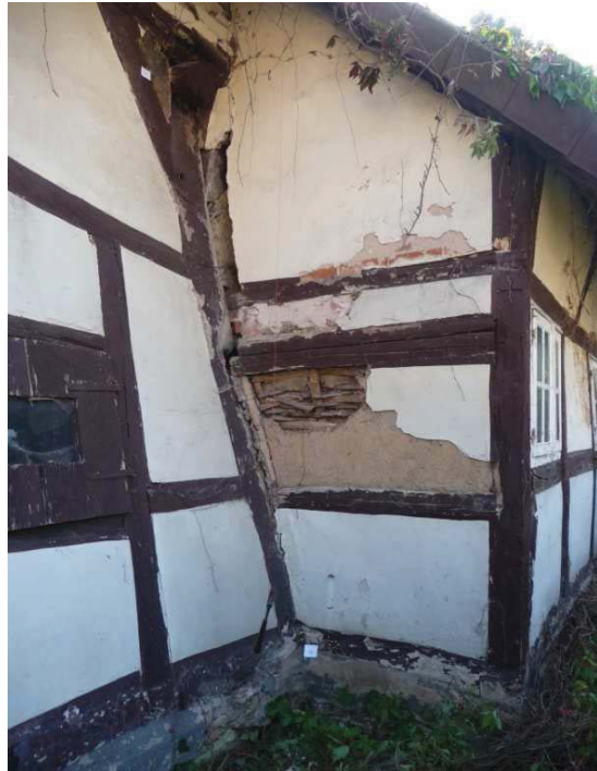
Abb. 8: Schaden durch Setzungen
